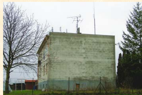
Nízky tepelný odpor muriva spôsobil kondenzáciu vodnej pary v pórobetóne. Následne čierna pleseň "vykreslila" každú tvárnicu. Náprava spočíva v paropriepustnom zateplení fasády pomocou dosiek STYRCON®.
