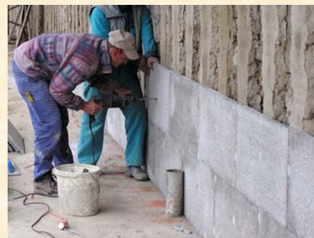
STYRCON® ako sanačná omietka. Na neizolované murivo z kameňotehly (z 19.str.), zbavené pôvodnej omietky sa naniesli vertikálne omietkové pásy. Na ne sa prikladali styrcónové dosky a kotvili o podklad plastovými hmoždinkami bez lepenia. Po zaarmovaní a nanesení minerálnej omietky táto už bude bez „vlhkých máp“, pričom vlhkosť sa v murive ventiluje.
